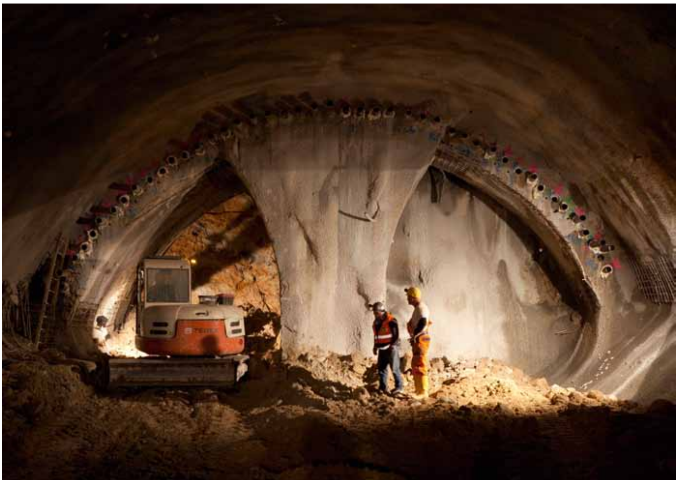
Ulmenstollenvortrieb im Hirschhagen Tunnel: Vorsichtiger Fortschritt in Teilausbrüchen Side wall drifting in the Hirschhagen Tunnel: cautious progress with part-excavations
