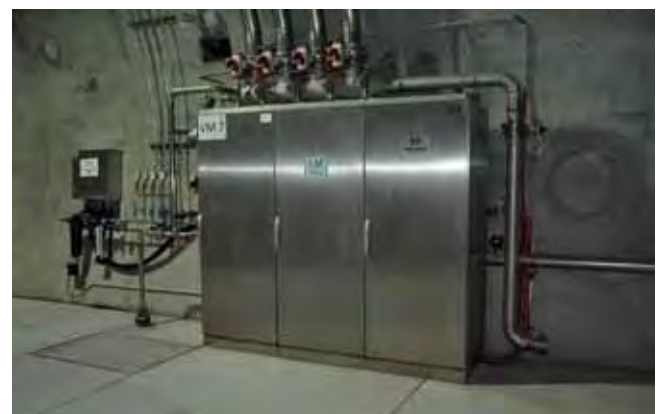
Verschäumungsmodul mit den darüber angeordneten Richtungsventilen. Links daneben ist eine Armaturengruppe zur Steuerluftversorgung der Löschbereichsventile in den Tunnelröhren zu sehen
