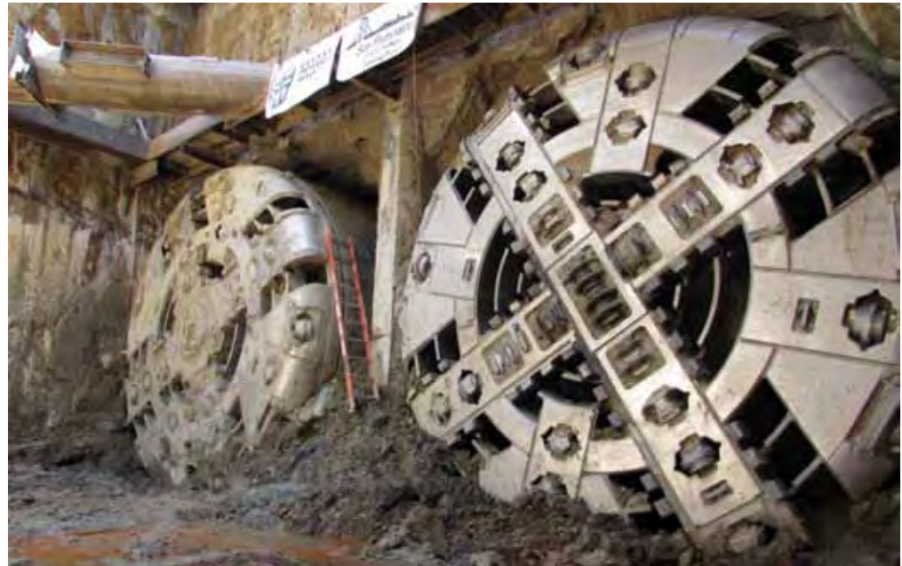
Zwei Robbins EPB-TBMs für wechselnde Geologien mit Förderbändern im Dauerbetrieb waren beim San Francisco Central Subway Tunnel im Einsatz. Der letzte Durchbruch erfolgte am 11. Juni 2014
