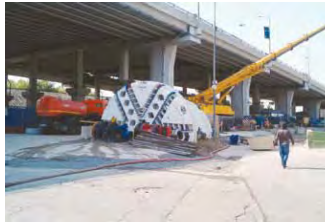
Dieser Robbins Bohrkopf wurde auf eine aufbereitete Lovat TBM aufgesetzt, die ihre Bohrarbeiten zwischen Chodinskoje Pole und Polezhaevskaya verrichtete
