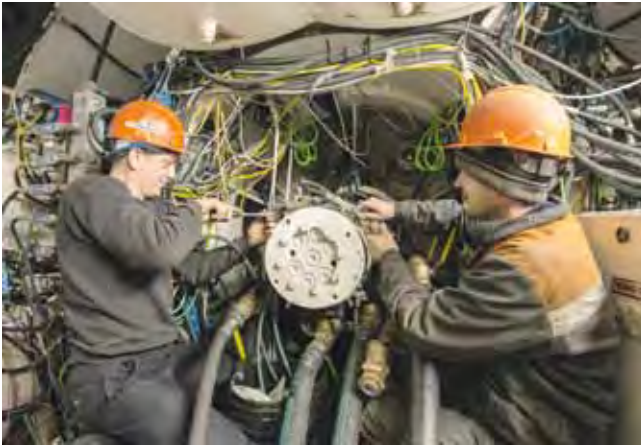
Einsatz auf verschiedenen Baustellen: Tunnelbauspezialisten bereiten eine Tunnelbohrmaschine für ihren erneuten Einsatz unter Tage beim Moskauer Metro-Projekt
