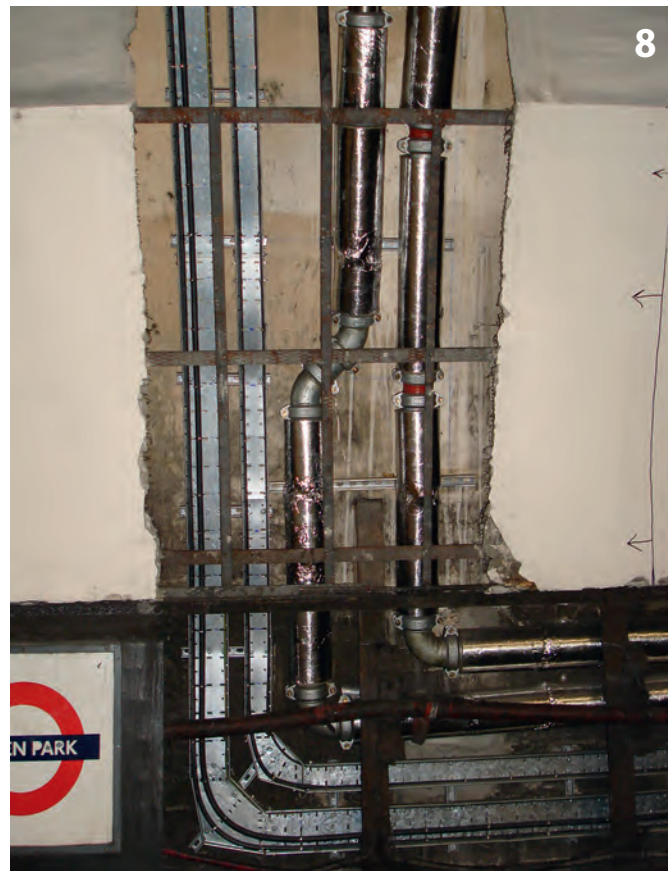
Londoner U-Bahn/GB, Haltestelle Greenpark – durch Rohrleitungen mit genuteten mechanischen Verbindungen konnte Klimaanlage schnell und sicher nachgerüstet werden.
