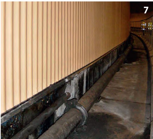
Die renovierte Haupt-Brandschutzleitung im Queensway-Mersey-Tunnel von Liverpool/GB wurde durch Kupplungen mit genuteten Enden verbunden: die Originalkupplungen der frühesten Bauart von Victaulic blieben mehr als 70 Jahre lang intakt.
