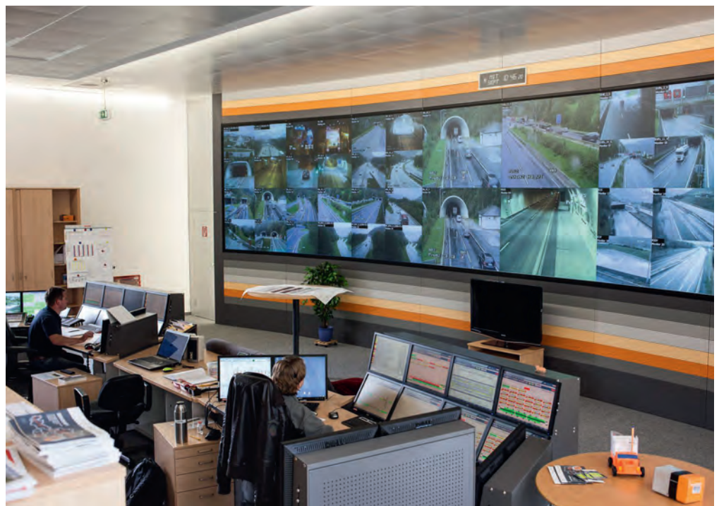
Leitzentrale des Tauerntunnels Tauern Tunnel control centre
