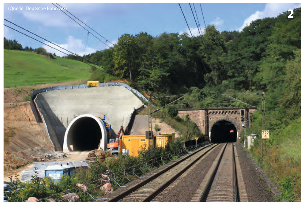
Bau des neuen Bebenroth-Tunnels zwischen Werleshausen und Eichenberg auf der Nord-Süd-Strecke Building the new Bebenroth Tunnel between Werleshausen and Eichenberg on the north-south route
