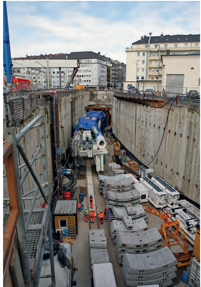
Im Startschacht werden die 6,6 t schweren Tübbinge auf den Tunnelzug geladen, der diese just in time direkt zur Einbaustelle transportiert
