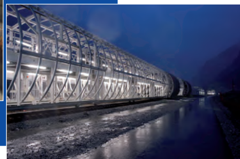
Nachläufer „Wurm“, Gotthard Basistunnel, Österreich
