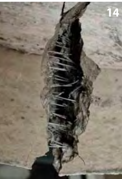
Stahlfaserbewehrter Tübbing nach dem Bruch
