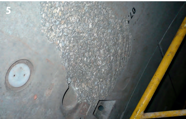
Abplatzung an der Erektorführung Spalling at the erector guide
