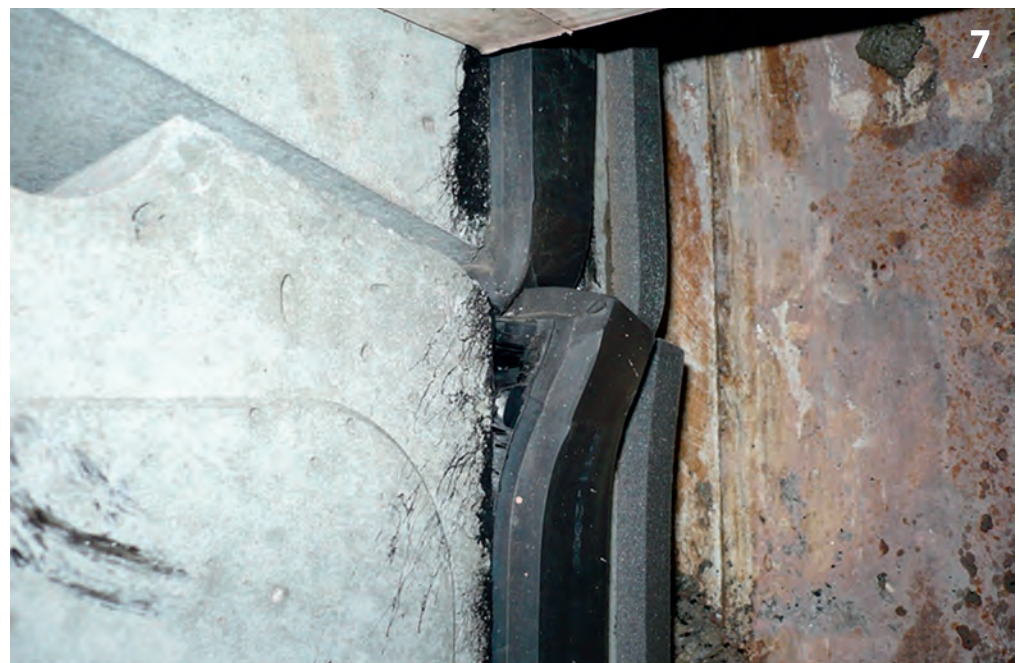
Losgelöste Dichtung am Schlussstein Loosened seal at the keystone
