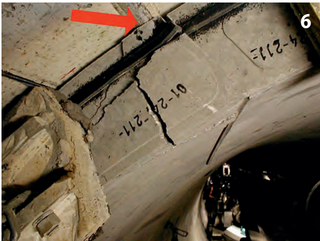
Abplatzung bei Kontakt Tübbing - Schildschwanz Spalling given contact between segment and shield tail
