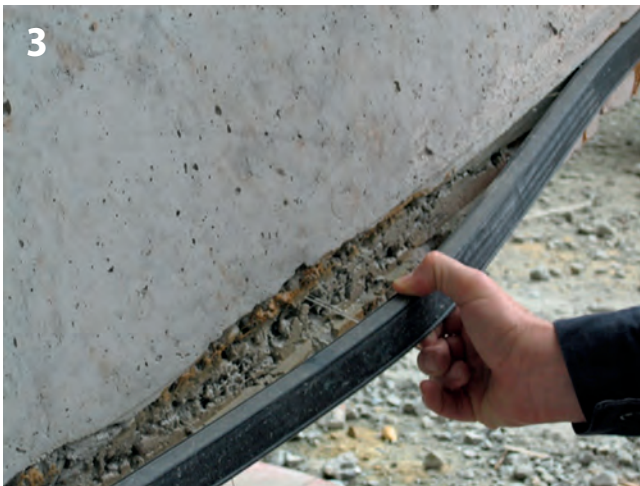
3 Luftporen im Dichtungsbereich Air pores in sealing area
