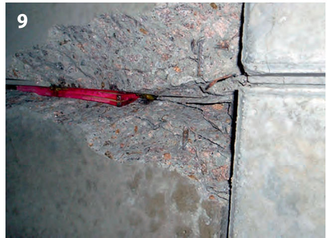
9 Abplatzungen durch Packing Spalling due to packing
